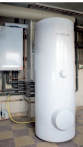
Der neue 300-Liter-Wassertank, der parallel Sonnen- und Kesselwärme speichert
